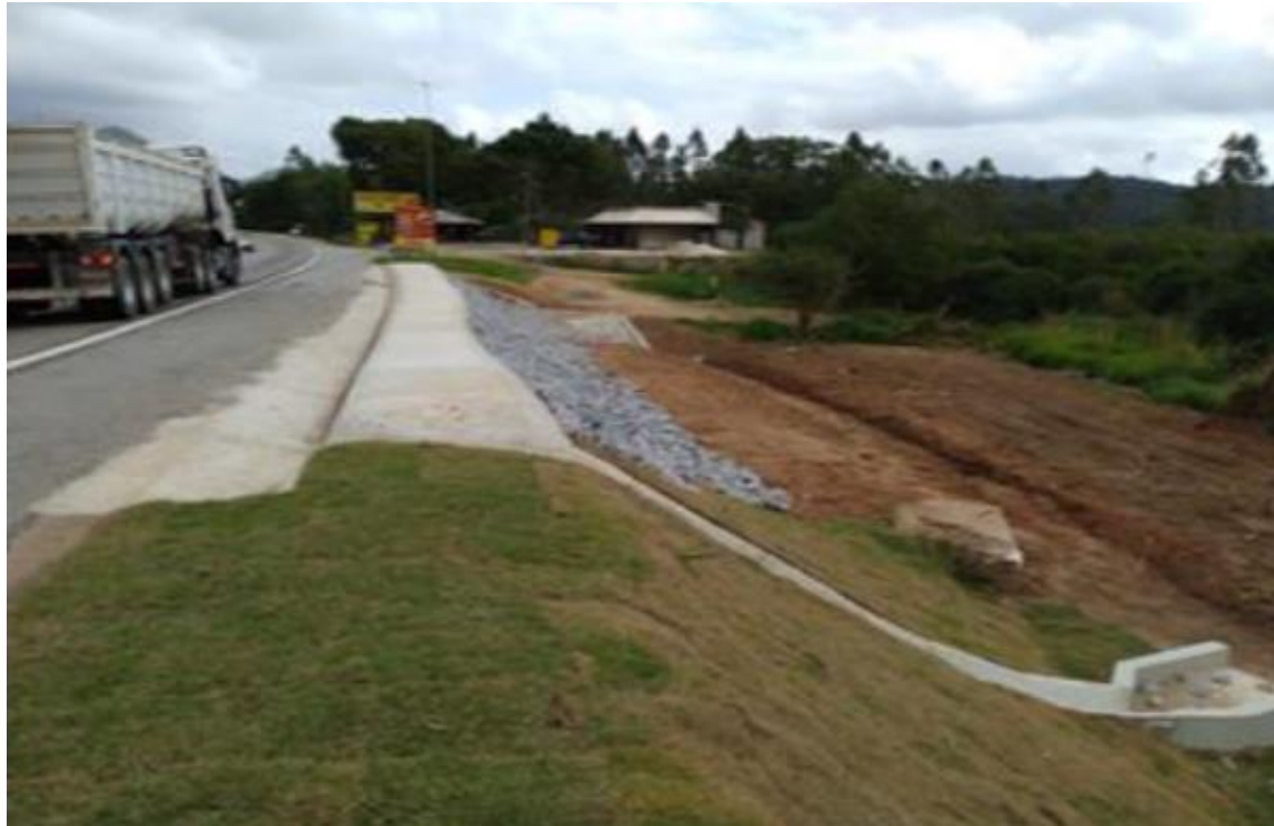
Figura 6.15 Via Lagos – Talude de aterro – Km 19+900 Sul
