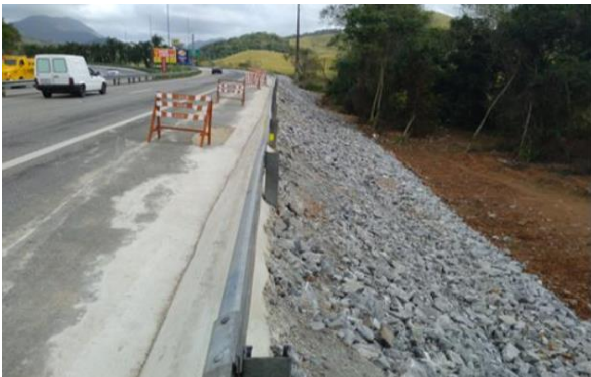
Figura 6.16 Via Lagos – Talude de aterro – Km 23+100 Sul
