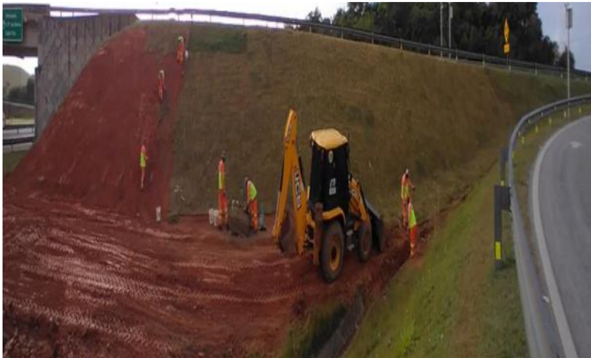
Figura 6.14 Via Lagos – Talude de aterro – Km 21+900 Norte
