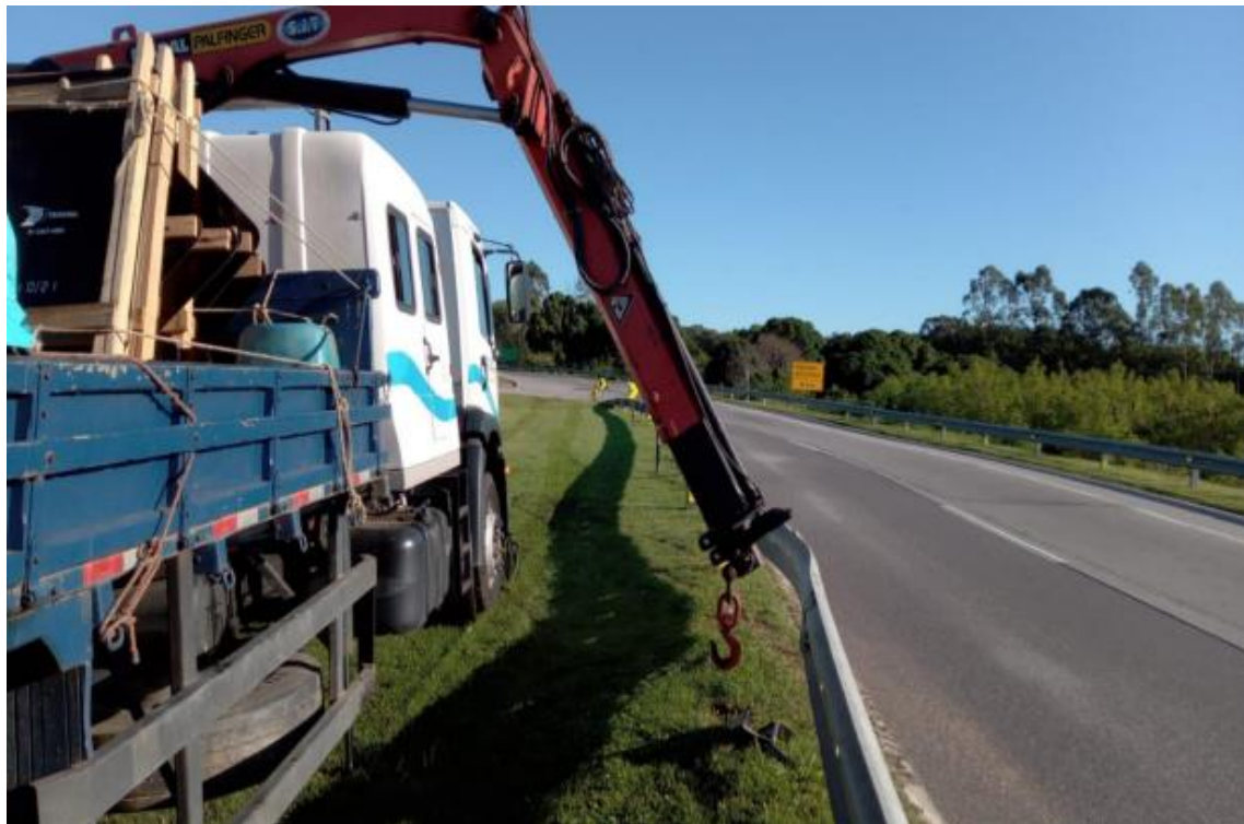
Figura 6.5 Via Lagos – Dispositivo de segurança – Km 29+100 Sul
