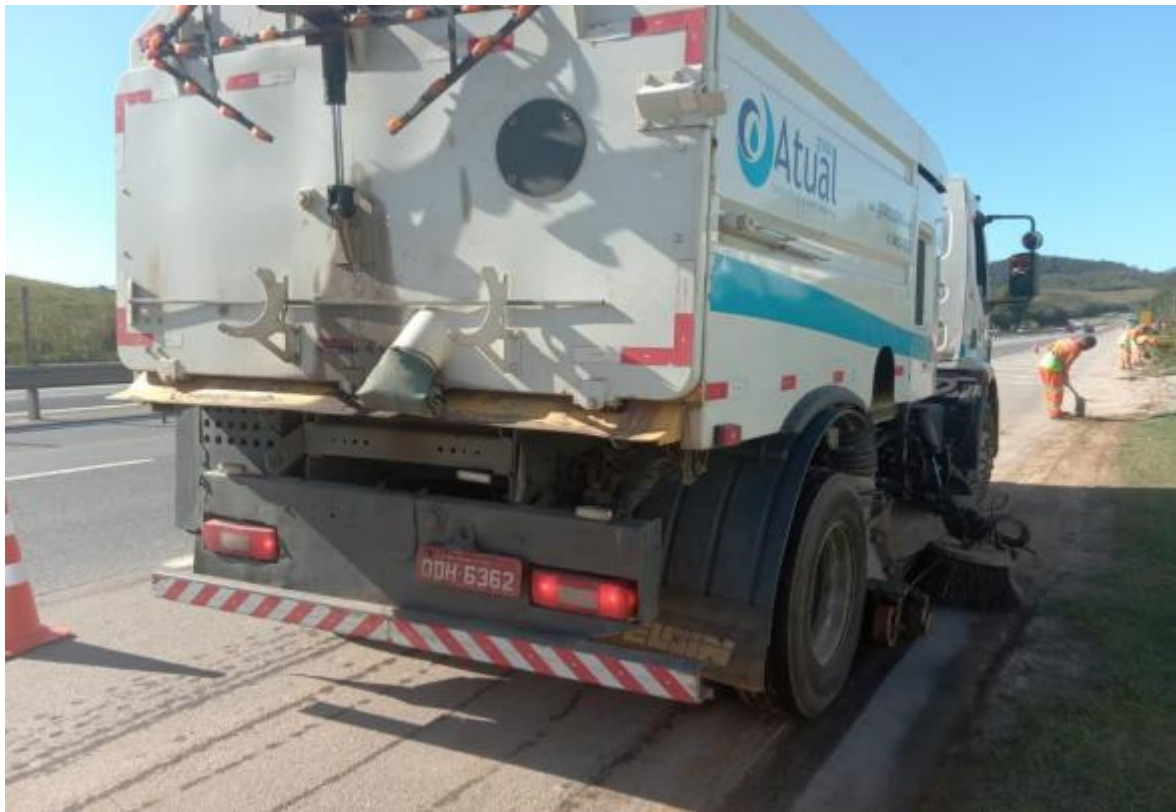
Figura 6.11 Via Lagos – Varrição de acostamento– Km 3+400 Norte
